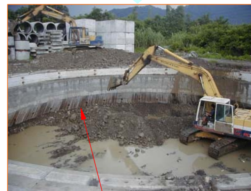
刃口根元を掘削すると自重で沈下 沈下しない場合は圧入で強制沈下
